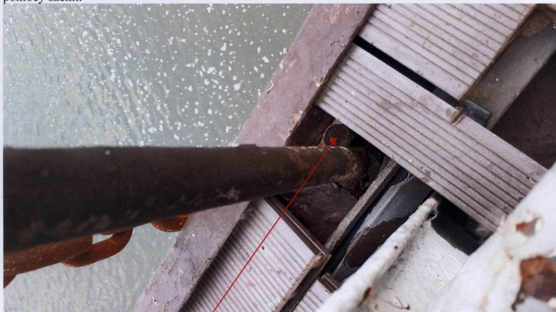
Zdj. Nr 4 – pęknięty wieszak prętowy.
