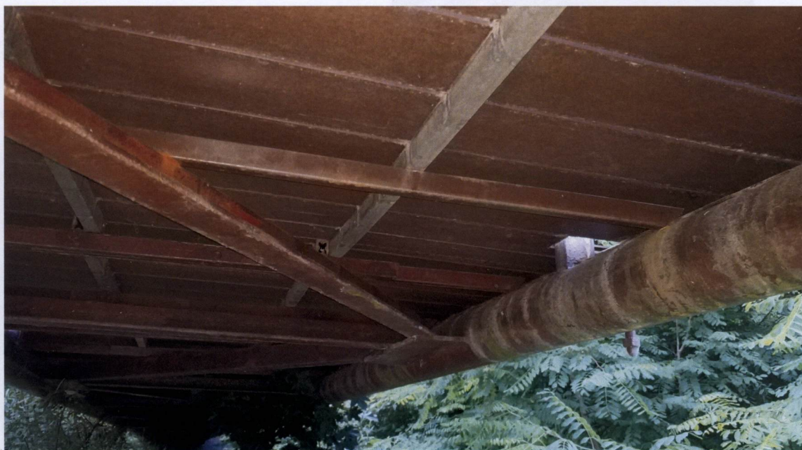
Zdj. Nr 6 – podkonstrukcja stalowa pomostu – profile 40x27x3mm oparte na konstrukcji kratowej pomostu, bez zamocowania. Podłużnie widoczne kompozytowe prostokątne „legary”, do których przykręcono „deski”.
