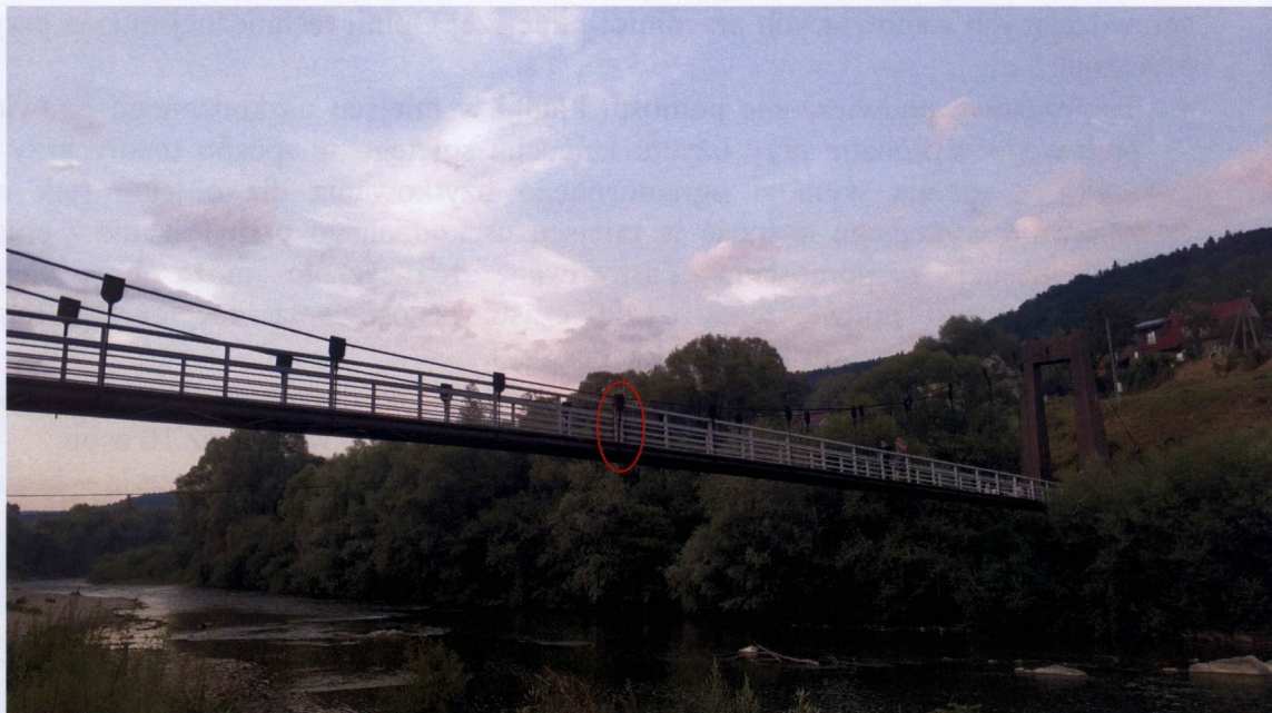
Zdj. Nr 1 – ogólny widok na obiekt mostowy – wskazano miejsce tymczasowej naprawy.
