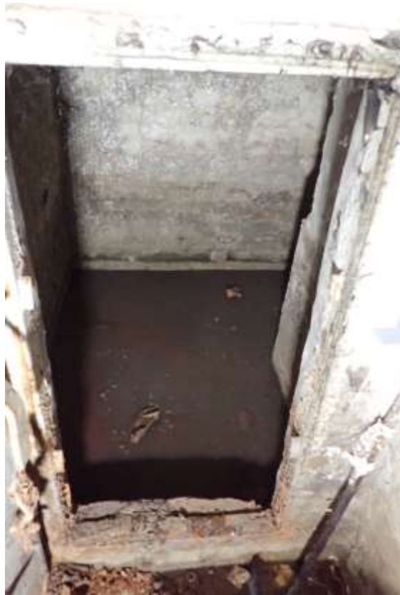
Fotogram nr 29 – Zalany wodą tunel wyjścia zapasowego. – Źródło: zdjęcia własne z wizji lokalnej.
