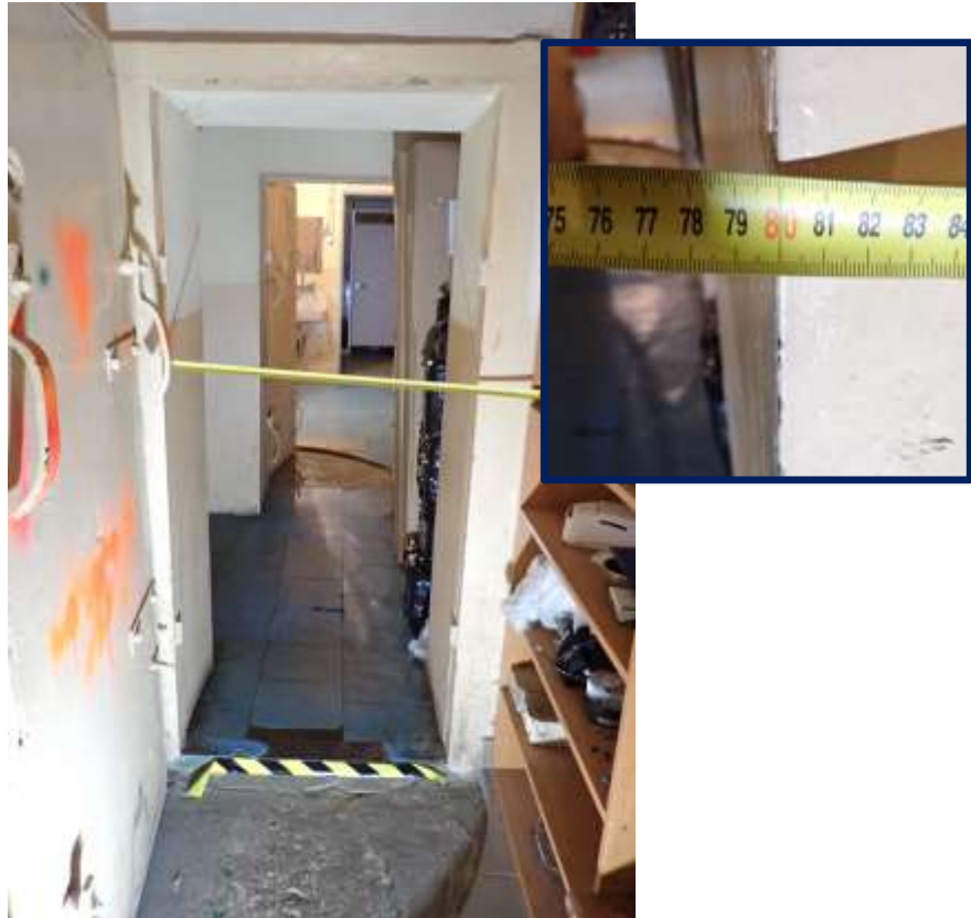
Fotogram nr 37 – Pomiar szerokości otworu wejściowego. – Źródło: zdjęcia własne z wizji lokalnej.
