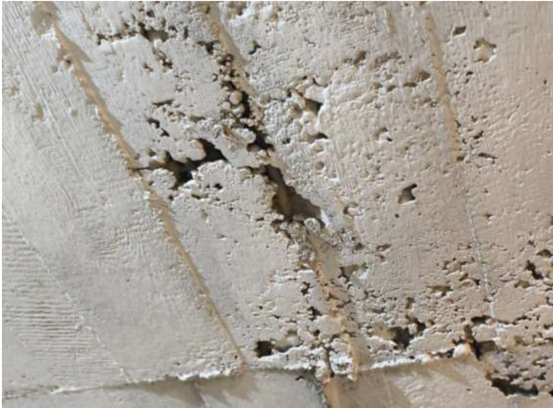
Fotogram nr 26 - Widoczne raki w stropie budowli ochronnej. – Źródło: zdjęcia własne z wizji lokalnej.
