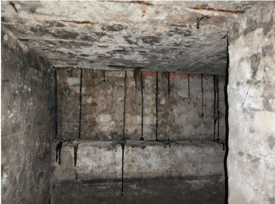
Fotogram nr 28 - Korozja zbrojenia oraz nieszczelności na połączeniu stropu z ścianą tunelu wyjścia zapasowego. – Źródło: zdjęcia własne z wizji lokalnej.
