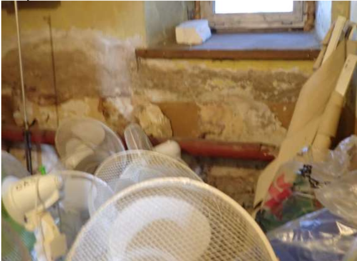
Fotogram nr 31 – Degradacja tynku. – Źródło: zdjęcia własne z wizji lokalnej.
