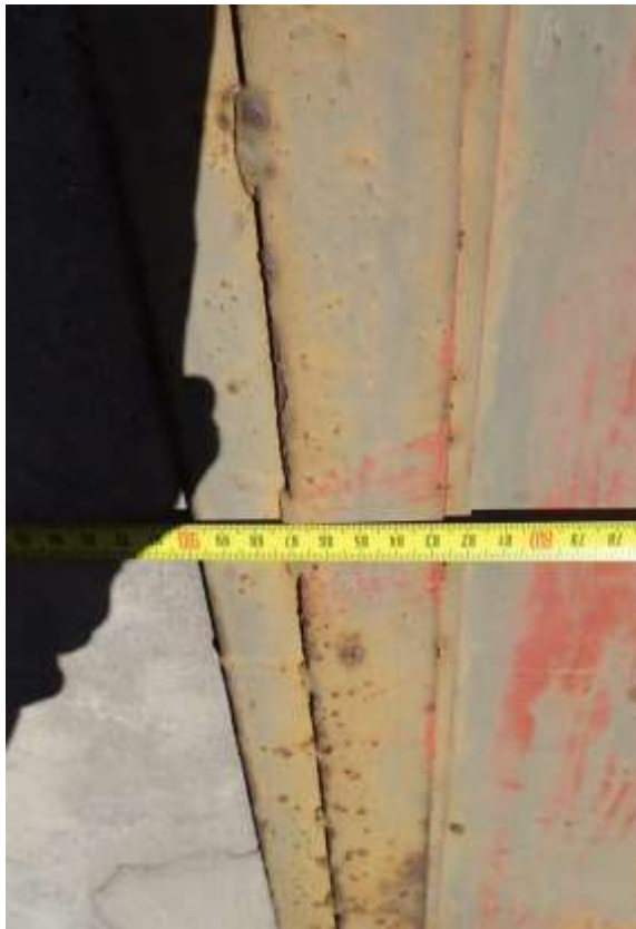
Fotogram nr 34 – Pomiar szerokości wyjścia awaryjnego. – Źródło: zdjęcia własne z wizji lokalnej.
