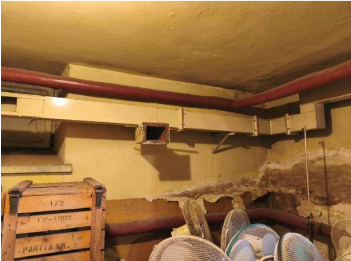
Fotogram nr 30 - Pozostałości instalacji wentylacyjnej. – Źródło: zdjęcia własne z wizji lokalnej.
