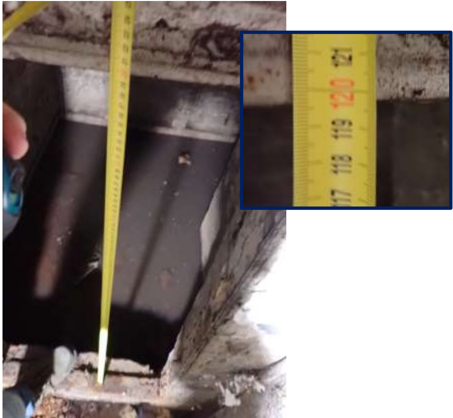
Fotogram nr 39 – Pomiar wysokości otworu wejściowego drzwi zapasowych. – Źródło: zdjęcia własne z wizji lokalnej.
